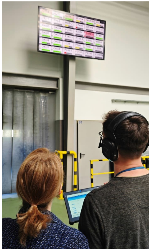
Rys. 5.7 Zainstalowany ekran TV z dashboardem prezentującym przebieg procesu produkcji
