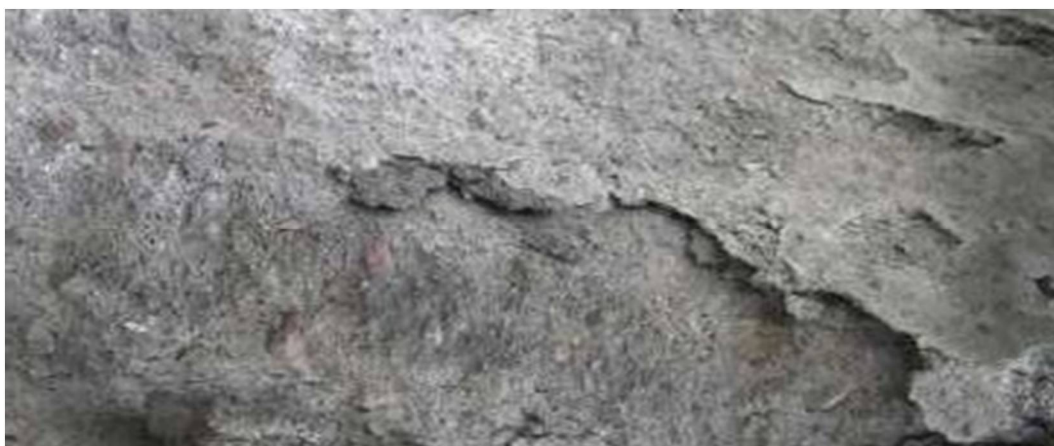
Rysunek 1.1. Uszkodzenie powierzchni stropu
