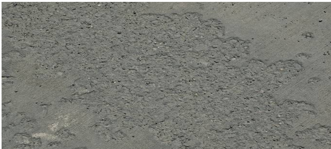
Rysunek 1.2. Uszkodzenie posadzki przemysłowej
