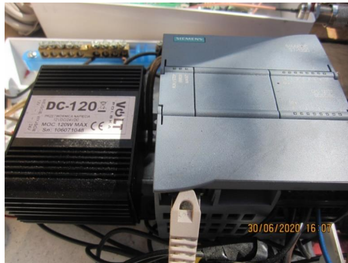
Rys. 4.6 Sterownik PLC firmy Siemens SIMATIC S7-1200 z przetwornicą napięcia WOLT DC-120 (opracowanie własne)
