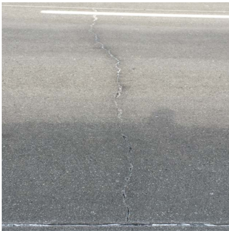
Rysunek 51. Spękanie płyty betonowej o dużej szkodliwości powstałe tuż po etapie wykonania nawierzchni w wyniku nieodpowiedniej pielęgnacji w czasie występowania wysokiej temperatury otoczenia.
