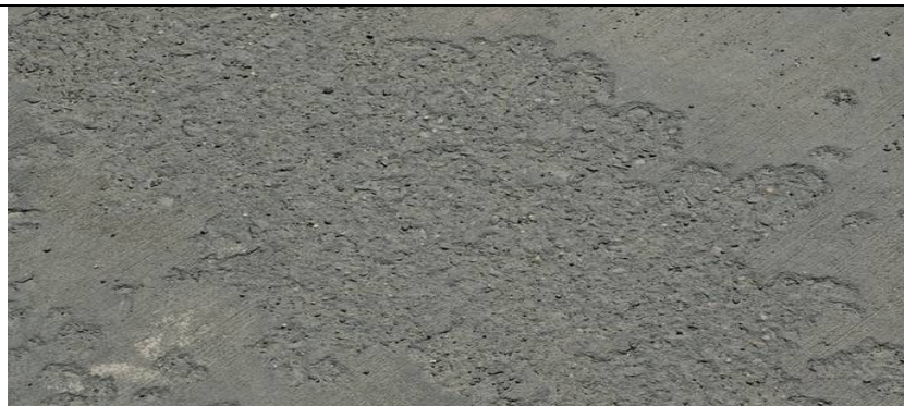
Rysunek 1.2. uszkodzenie posadzki przemysłowej
