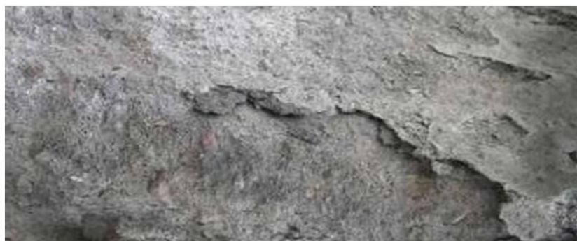
Rysunek 1.1. uszkodzenie powierzchni stropu
