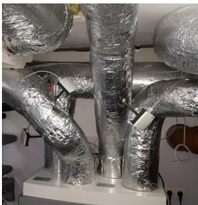
Rys. 3.2 Kanałowe czujniki temperatury i wilgotności powietrza w układzie wentylacji mechanicznej
