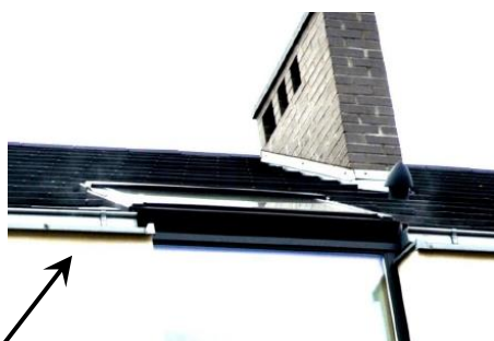
Rys. 4–10. Przeciek powietrza w pobliżu okna przy ścianie kolankowej
