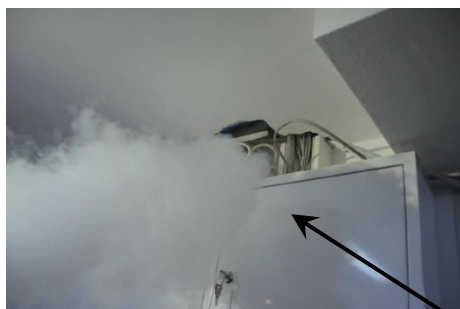
Rys. 4–12. Przepięk powietrza przez szacht instalacyjny na połączeniu piwnicy nieogrzewanej z przestrzenią mieszkalną
