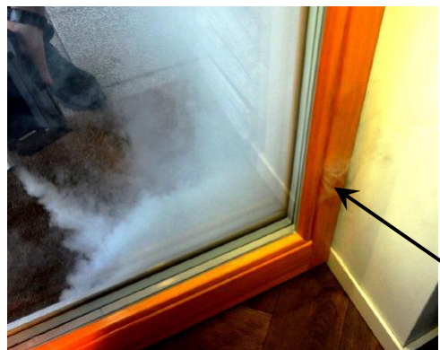
Rys. 5-39. Przeciek powietrza przez ramę okienną
