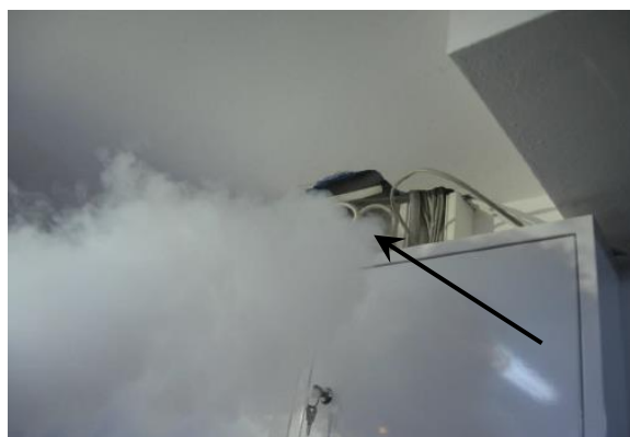
Rys. 5-40. Przeciek powietrza przez szacht instalacyjny na połączeniu piwnicy nieogrzewanej z przestrzenią mieszkalną
