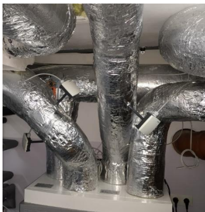
Rys. 3–16. Kanałowe czujniki temperatury i wilgotności powietrza w układzie wentylacji mechanicznej
