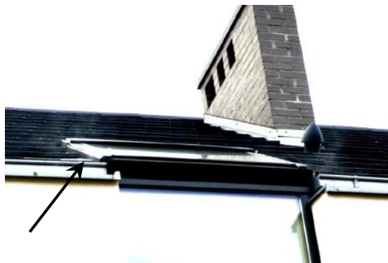
Rys. 5-38. Przeciek powietrza w pobliżu okna przy ścianie kolankowej
