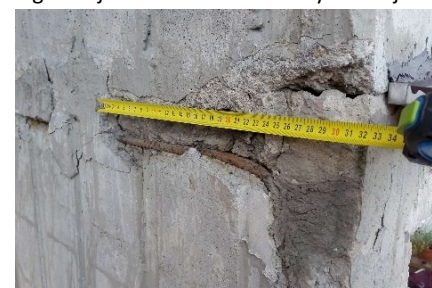
f) degradacja elementu z widocznym zbrojeniem
