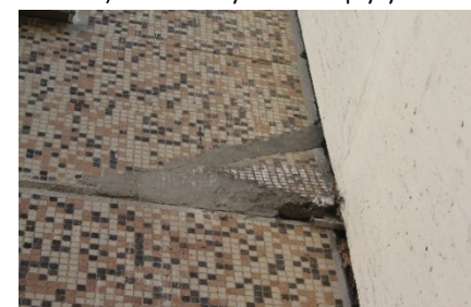
h) uszkodzony narożnik płyty
