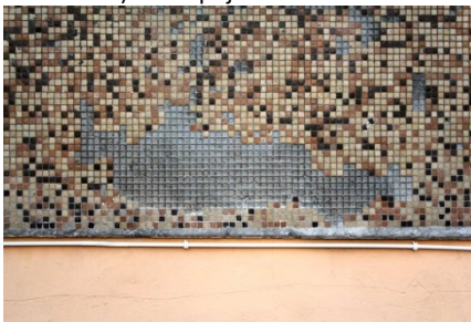
a) odspojenie witromozaiki
