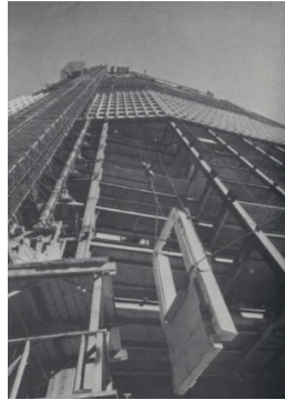
Rysunek 26 Panel ścienny w trakcie montażu na Pan American Building w Nowym Jorku (1962 r.) [62]
