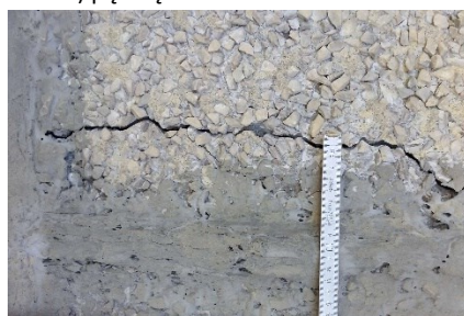
e) pęknięcie narożnika elementu
