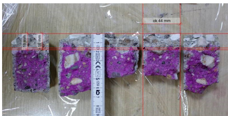
Rysunek 40 Zobrazowana analiza zasięgu karbonatyzacji betonu warstwy fakturowej – System „Rataje” [119]
