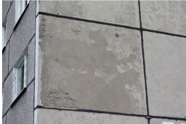
Rysunek 72 Element ścienny niespełniający warunków brzegowych wykonania wzmocnienia
