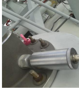
Rys. 7a. Sonda zainstalowana w gnieździe pomiarowym przepustu
