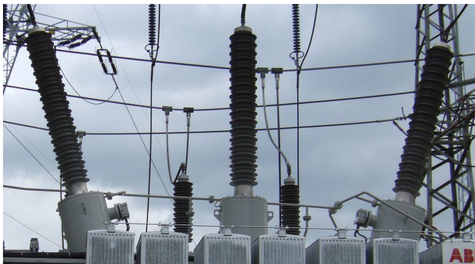
Rys. 1.1. Izolatory przepustowe transformatora 400/110 kV o mocy 160MVA; na pierwszym planie strona napięcia 400kV
