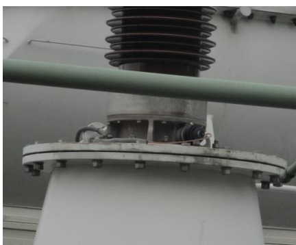
Rys. 4.9. Sonda umieszczona w gnieździe pomiarowym przepustu 400 kV
