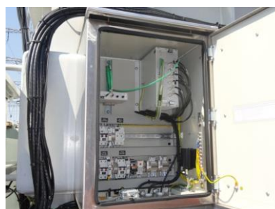
Rys. 6.32. Szafka z modułem pomiarowym zainstalowana na kadzi transformatora
