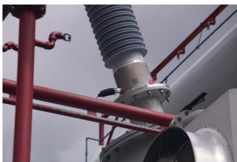
Rys. 6.31. Sonda zainstalowana w przepuście ze złączami zabezpieczonymi dodatkową osłoną
