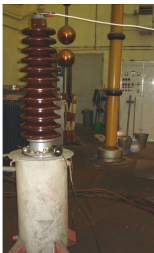
Rys. 14. Przepust z sondą pomiarową
