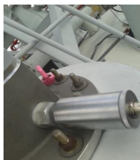
Rys. 6.10. Śruby mocujące kołnierz izolatora przepustowego, utrudniające montaż sondy pomiarowej
