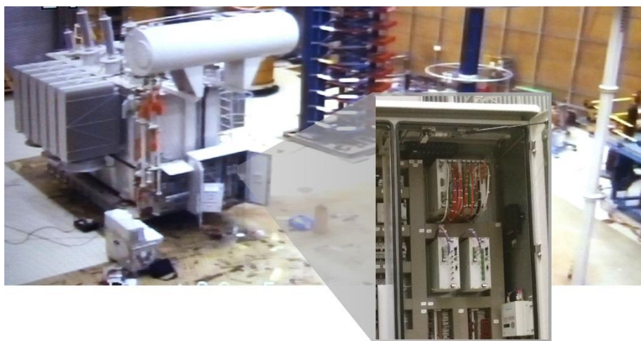
Rys. 17. Transformator 110/10 kV na stanowisku testowym z zainstalowanym modulem monitoringu SMT-102 w szafie sterowania transformatora
