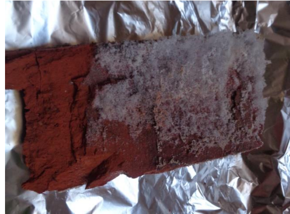
Fot. 2.7 Wykwity solne na wewnętrznej powierzchni odspojonego fragmentu cegły (fot.: autor)
