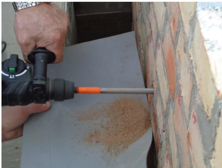
Fot. 4.8 Pobieranie zwiercin na potrzeby badania wilgotności muru przed wykonaniem iniekcji (fot.: autor)
