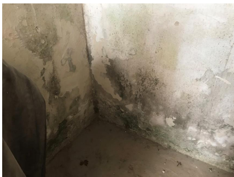
Fot. 2.4 Porażenie mykologiczne zawilgoconej przegrody (fot.: autor)
