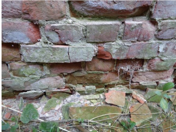
Fot. 2.6 Odspojenia warstw muru w wyniku krystalizacji soli w głębi muru (fot.: autor)
