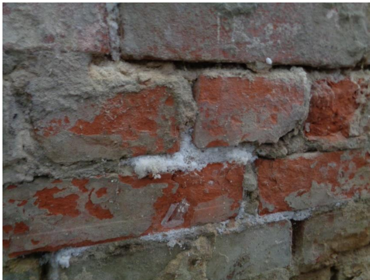
Fot. 2.5 Wykwity solne na powierzchni muru (fot.: autor)
