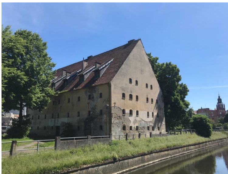
Fot. 2.1 Szkody spowodowane zawilgoceniem zabytkowego (1685 r.) spichlerza w Stargardzie Szczecińskim (fot.: autor)
