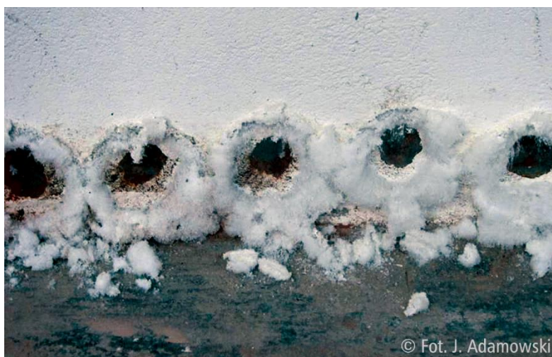
Fot. 4.2 Stan przegrody po dwóch latach od wykonania iniekcji krystalicznej (fot.: [156])
