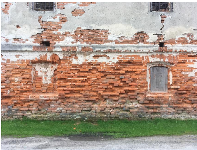
Fot. 2.3 Uszkodzenia konstrukcji murowej spowodowane destrukcyjnym działaniem mrozu (fot.: autor)
