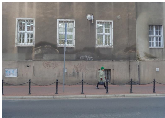
Fot. 3.1 Zawilgocenie ścian zewnętrznych na skutek kapilarnego podciągania wilgoci z gruntu (fot.: autor)
