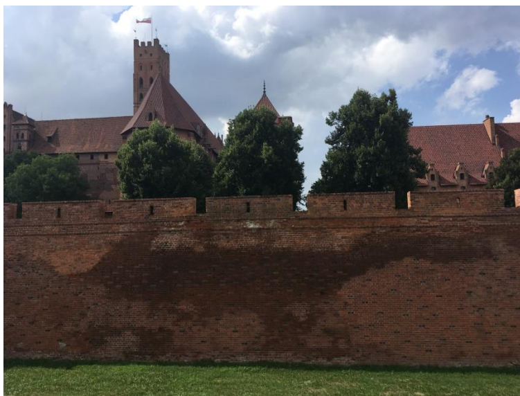
Fot. 2.8 Plamy wilgoci i wysolenia na murach zamku w Malborku (fot.: autor)
