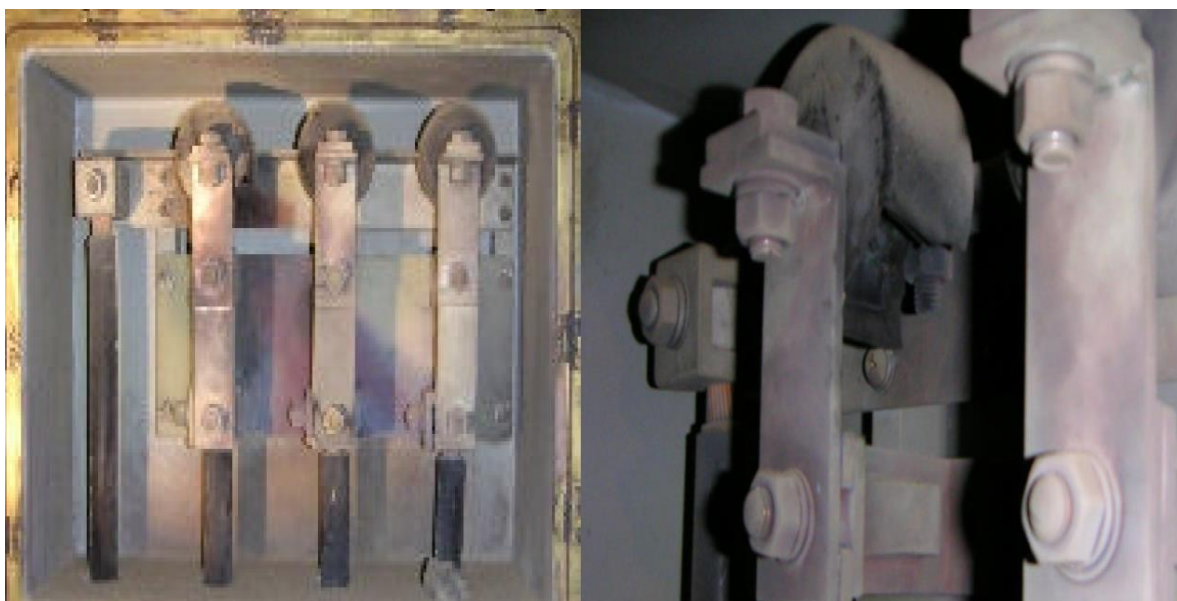
Rys. 1.2. Skutek awarii ogranicznika przepięć SVL w układzie z jednostronnym uziemieniem żył powrotnych (SPB) [26]
