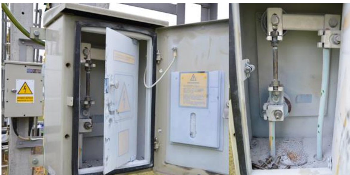
Rys. 1.1. Skutki awarii ogranicznika przepięć SVL w układzie z jednostronnym uziemieniem żył powrotnych (SPB) – (fot. Jaroslaw Parciak, onsite hv solutions)
