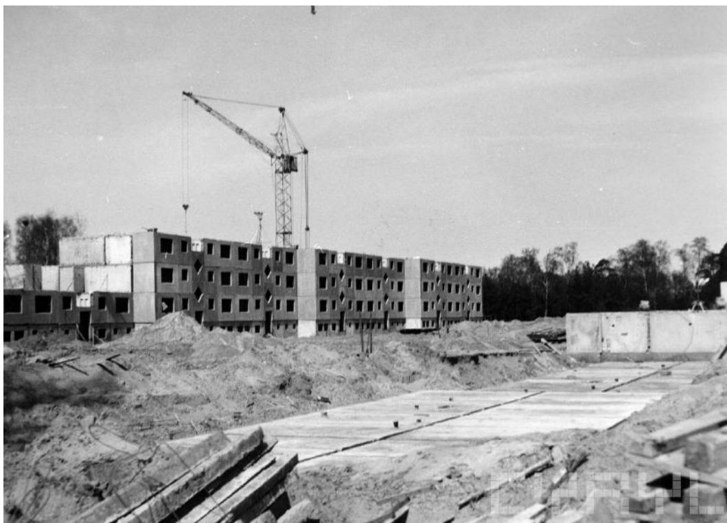
Ryc. 139 Budowa jednostek mieszkalnych na terenie osiedla Tysiąclecia, źródło: Cyfrowe Repozytorium Lokalne Poznań – CYRYL
