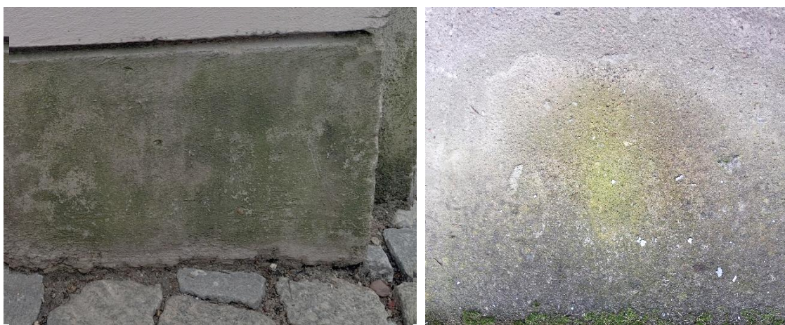
Rysunek 1.1. Przykład rozwoju biokorozji na powierzchni materiałów cementowych w Poznaniu
