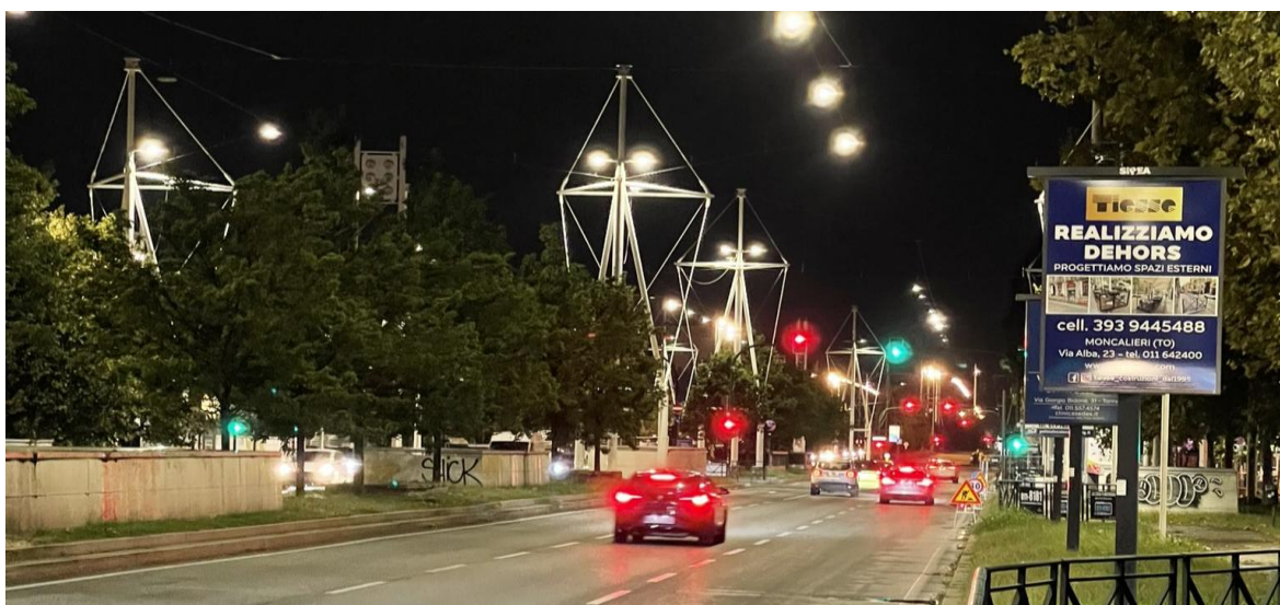
Ryc.37. Zaprojektowany indywidualnie system konstrukcji-laterni oświetlenia ulicznego. ul. Corso Inghilterra, Turyn (IT), Fot. P. Ratajkiewicz.
