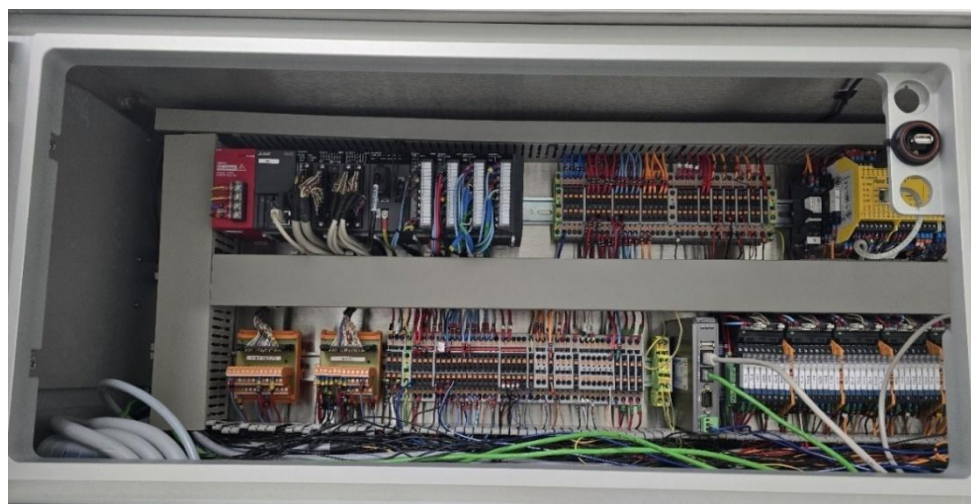
Rysunek 4.25. Szafa sterownicza systemu pakowania z modułami PLC i układem akwizycji danych (opracowanie własne na podstawie danych udostępnionych przez przedsiębiorstwo).
