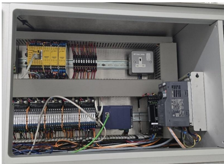
Rysunek 4.26. Szafa sterownicza systemu pakowania z modułami komunikacyjnymi OPC UA i routerem eWON współpracującym z panelami HMI (opracowanie własne na podstawie danych udostępnionych przez przedsiębiorstwo).
