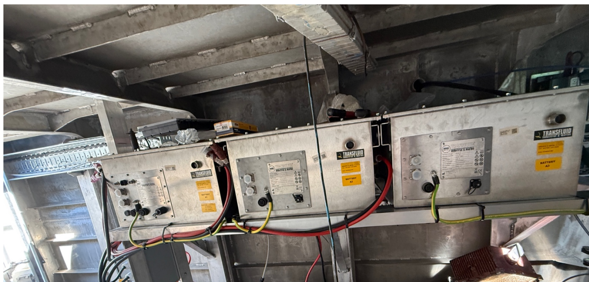
Rys. 15. Układ akumulatorów składający się z 3 jednostek po 30 kWh każda
