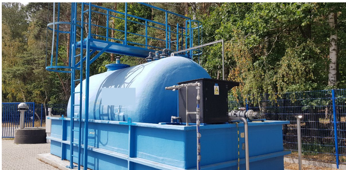
Rys. 2.15 Instalacja do dozowania chemii technologicznej (zdjęcie: M. Stachowiak)
