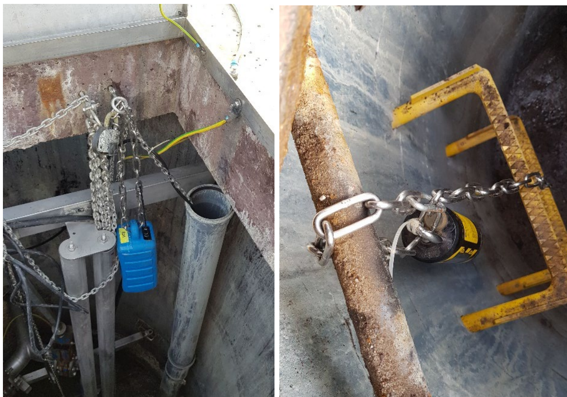
Rys. 2.13 Przykłady instalacji urządzeń do pomiaru H_2S w powietrzu w pompowniach i studzienkach kanalizacyjnych (zdjęcie: M. Stachowiak)
