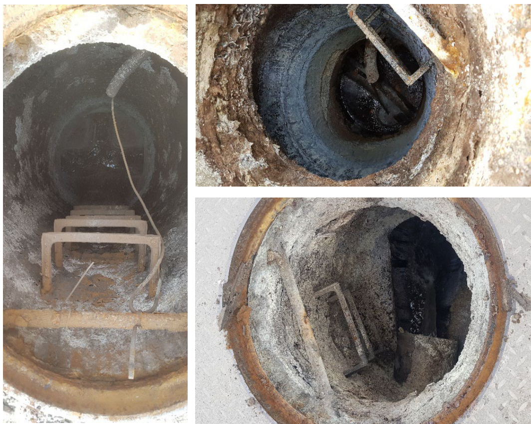
Rys. 2.14 Korozja siarczanowa betonu (zdjęcia: M. Stachowiak)
