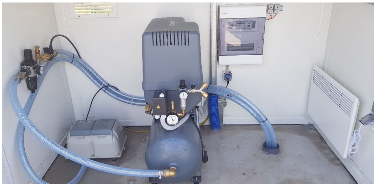
Rys. 2.16 Instalacja do napowietrzania rurociągu tłoczego (zdjęcie: M. Stachowiak)
